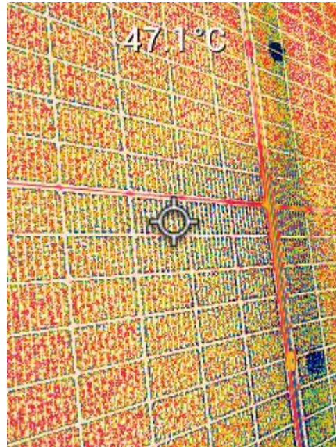
Figura 15 - Imagem térmica módulo 10.
