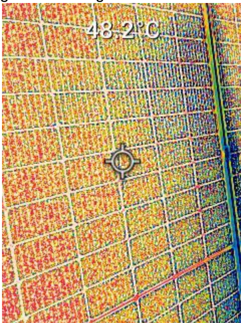
Figura 16 - Imagem térmica módulo 11.
