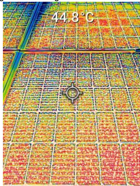
Figura 17 - Imagem térmica módulo 12.
