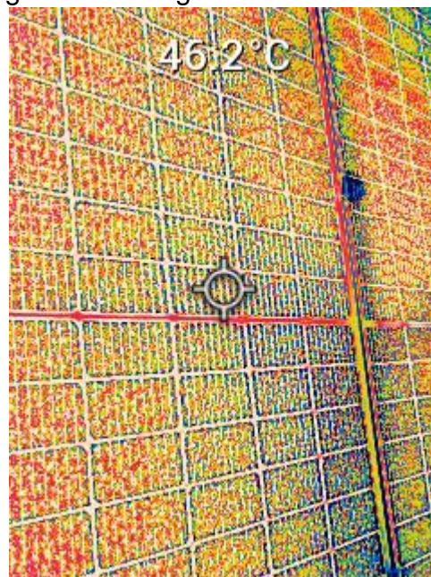
Figura 13 - Imagem térmica módulo 8.
