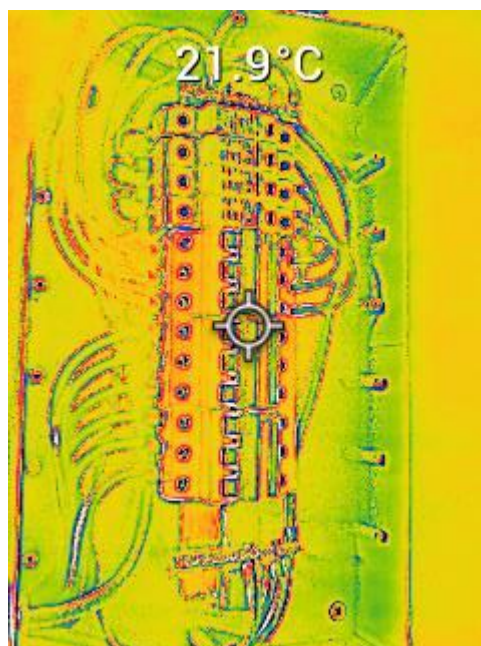
Figura 26 – Imagem com a câmera térmica do quadro principal da conexão CA.
