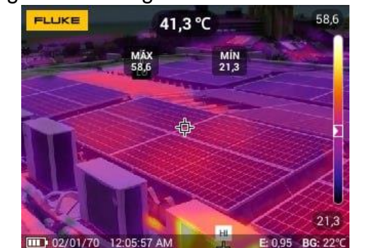
Figura 53 - Imagem térmica módulo 51.
