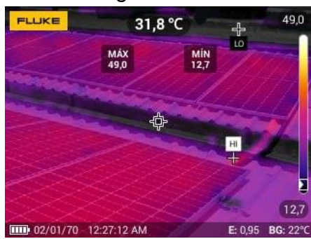
Figura 29 - Imagem térmica módulo 27.
