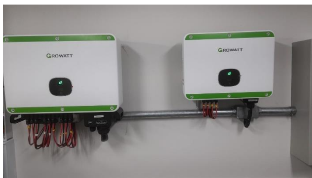
Figura 1- Imagem do cabeamento da entrada CC dos inversores.
