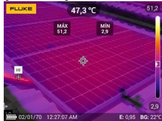
Figura 28 - Imagem térmica módulo 26.
