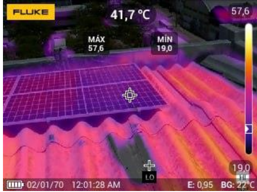
Figura 35 - Imagem térmica módulo 33.
