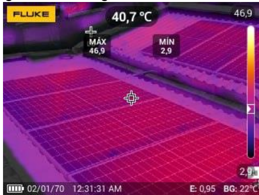
Figura 27 - Imagem térmica módulo 25.
