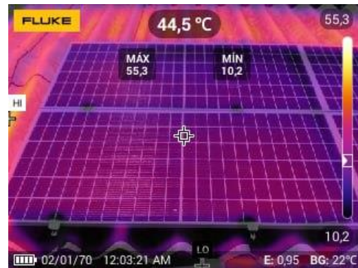
Figura 40 - Imagem térmica módulo 38.
