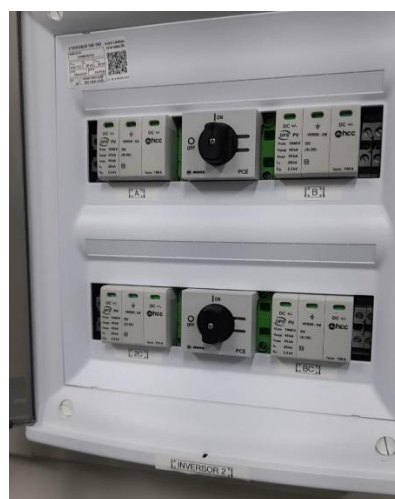
Figura 2- Imagem stringbox com identificação.
