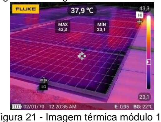
Figura 21 - Imagem térmica módulo 19.
