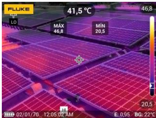
Figura 47 - Imagem térmica módulo 45.
