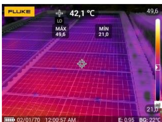
Figura 3 - Imagem térmica módulo 1.
