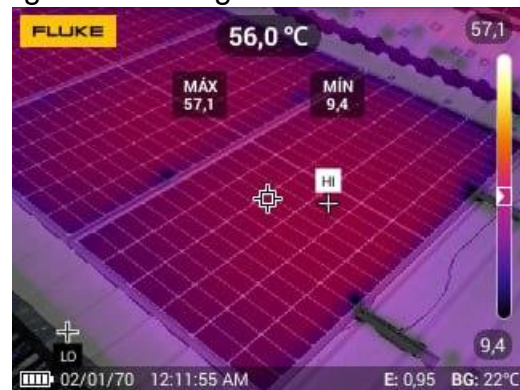
Figura 12 - Imagem térmica módulo 10.
