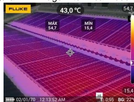
Figura 14 - Imagem térmica módulo 12.
