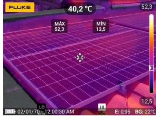
Figura 36 - Imagem térmica módulo 34.
