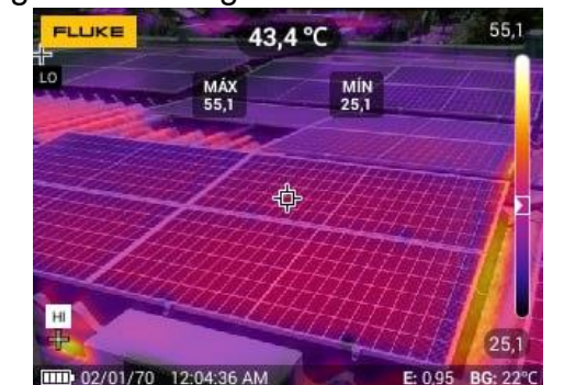
Figura 45 - Imagem térmica módulo 43.
