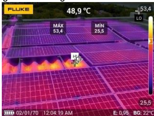
Figura 43 - Imagem térmica módulo 41.
