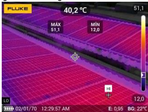
Figura 25 - Imagem térmica módulo 23.
