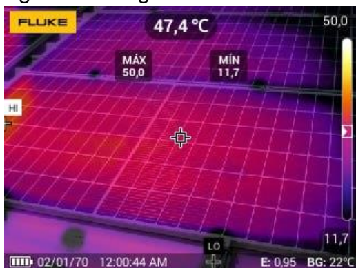
Figura 9 - Imagem térmica módulo 7.
