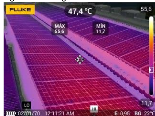
Figura 10 - Imagem térmica módulo 8.
