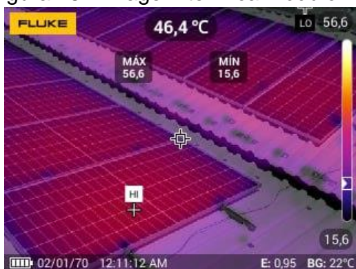
Figura 17 - Imagem térmica módulo 15.
