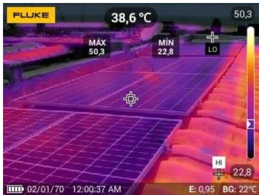
Figura 31 - Imagem térmica módulo 29.
