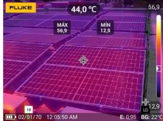
Figura 52 - Imagem térmica módulo 50.
