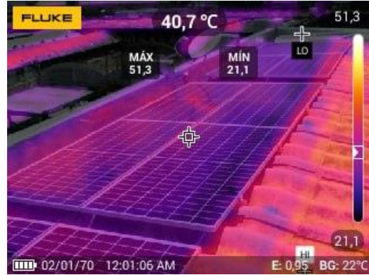
Figura 34 - Imagem térmica módulo 32.
