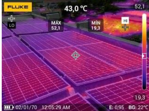
Figura 51 - Imagem térmica módulo 49.
