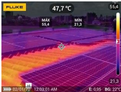
Figura 39 - Imagem térmica módulo 37.
