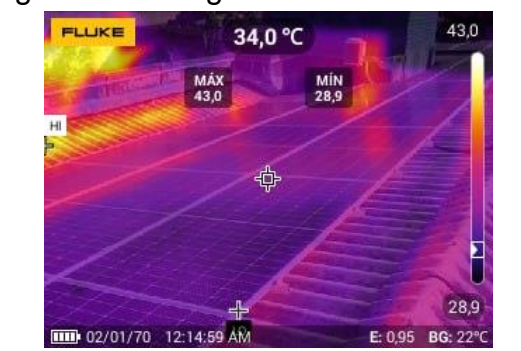
Figura 20 - Imagem térmica módulo 18.
