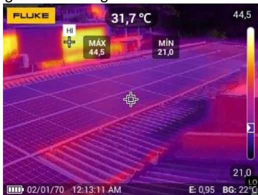
Figura 17 - Imagem térmica módulo 15.
