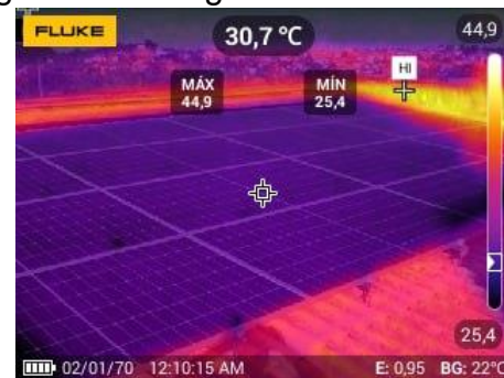
Figura 12 - Imagem térmica módulo 10.
