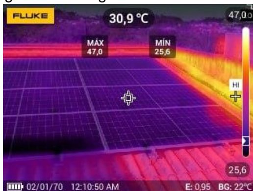
Figura 15 - Imagem térmica módulo 13.
