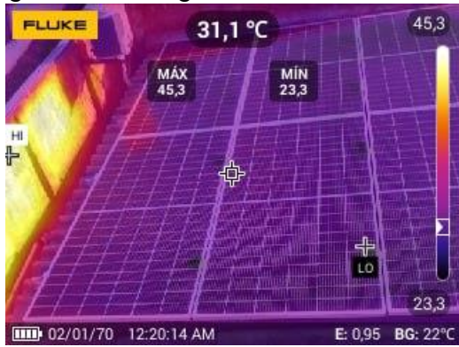
Figura 33 - Imagem térmica módulo 31.
