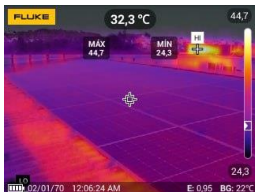
Figura 3 - Imagem térmica módulo 1.
