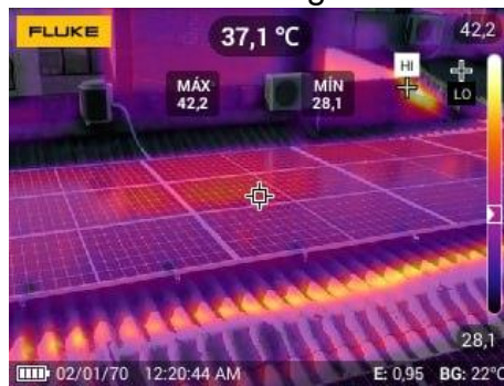
Figura 35 - Imagem térmica módulo 33.
