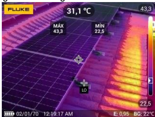
Figura 25 - Imagem térmica módulo 23.
