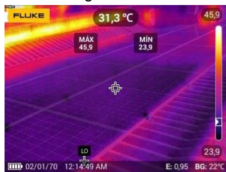
Figura 27 - Imagem térmica módulo 25.
