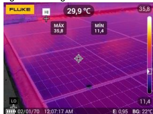
Figura 8 - Imagem térmica módulo 6.
