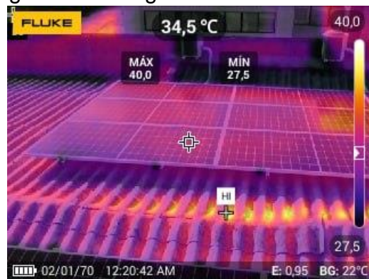
Figura 32 - Imagem térmica módulo 30.
