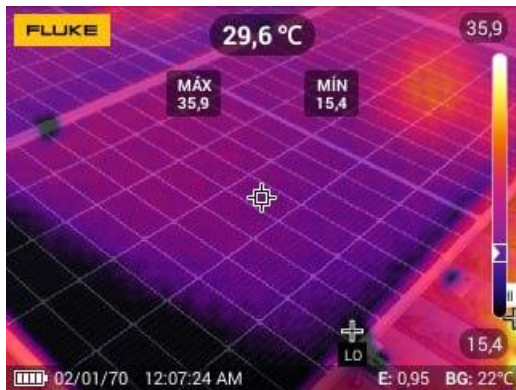
Figura 5 - Imagem térmica módulo 3.
