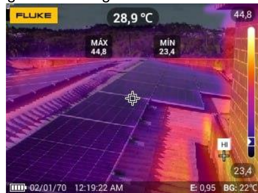
Figura 26 - Imagem térmica módulo 24.
