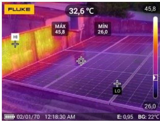
Figura 21 - Imagem térmica módulo 19.
