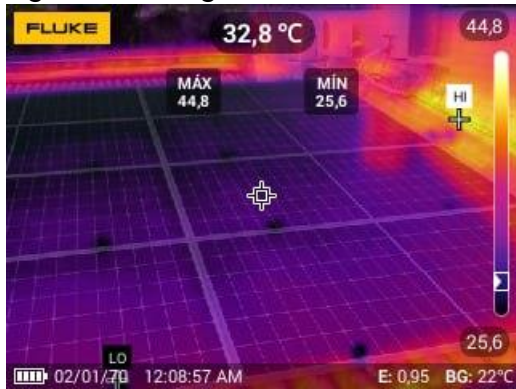
Figura 9 - Imagem térmica módulo 7.
