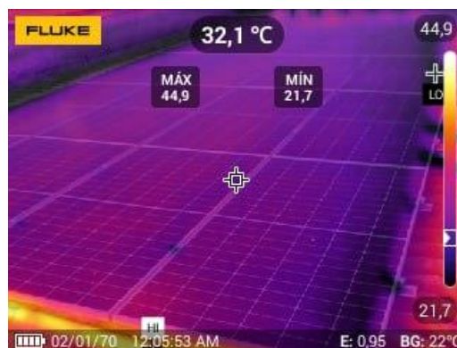
Figura 4 - Imagem térmica módulo 2.
