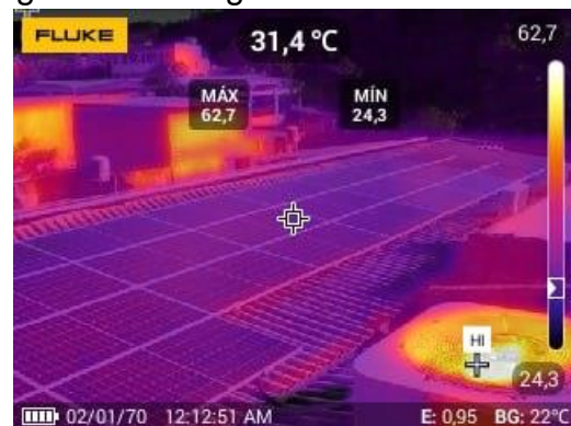
Figura 16 - Imagem térmica módulo 14.
