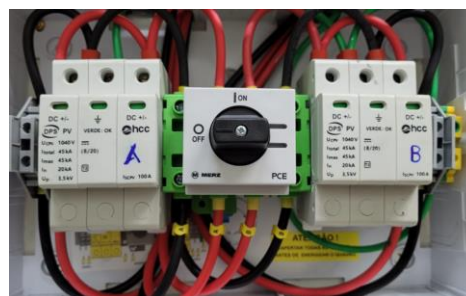
Figura 2- Imagem stringbox sem identificação.
