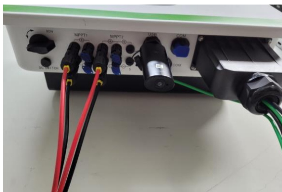
Figura 1- Imagem do cabeamento da entrada CC dos inversores.
