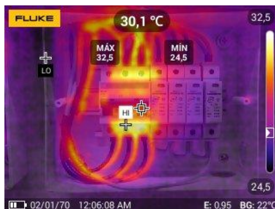
Figura 4 – Imagem com a câmera térmica do quadro de conexão CA.
