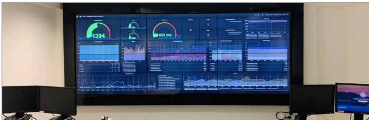
Videowall na sala de monitoramento e operações de rede
